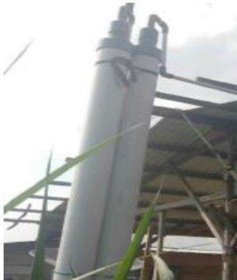
Gambar 9 Tabung pemurnian biogas
