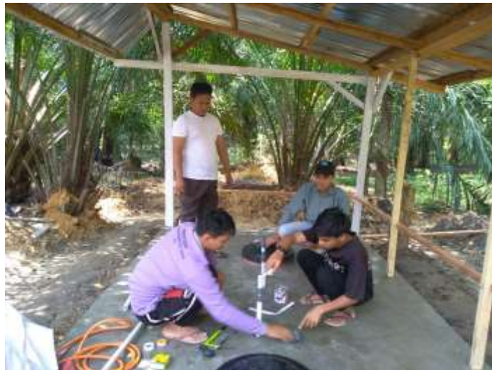
Gambar 15 pemipaan pada sistem saluran gas
