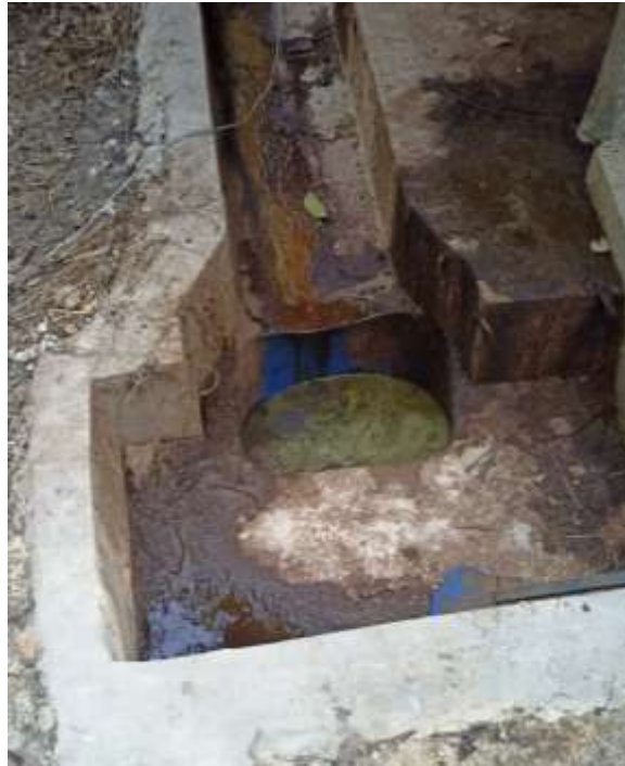
Gambar 41 Penyumbatan di bagian pengadukan
