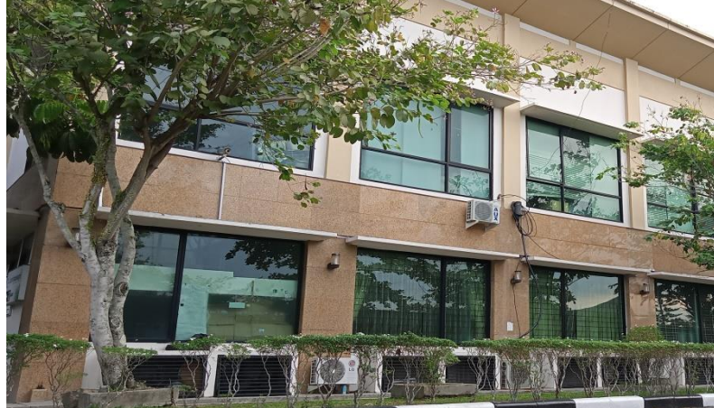
Gambar 5. 19 Beams do not align with coloumns pada Gedung Kantor Bidang Ekonomi, Pembangunan dan Kesra Kampar
