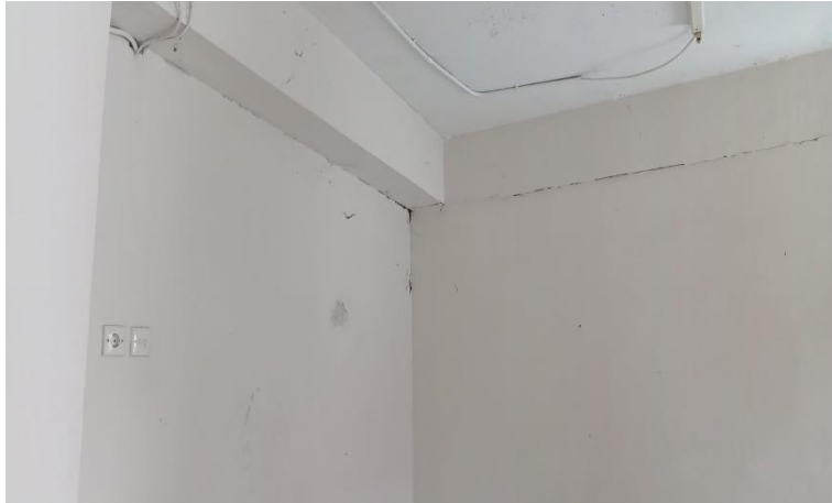
Gambar 4. 25 Keretakan pada dinding Gedung Kantor Bidang Ekonomi, Pembangunan dan Kesra Kampar
