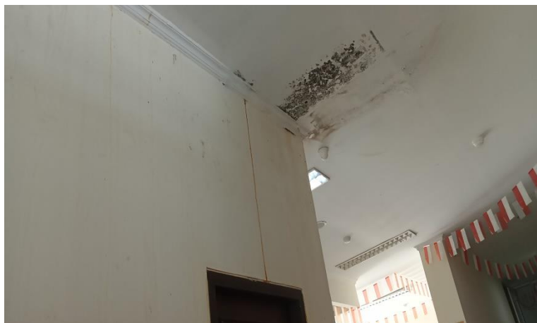
Gambar 4. 27 Kerusakan pada plafond Gedung Kantor Bidang Ekonomi, Pembangunan dan Kesra Kampar
