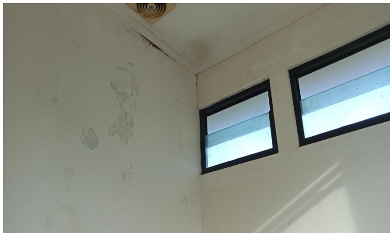
Gambar 4. 33 Kerusakan pada plafond Gedung Kantor Tata Pemerintahan, Hukum, dan Politik Kampar
