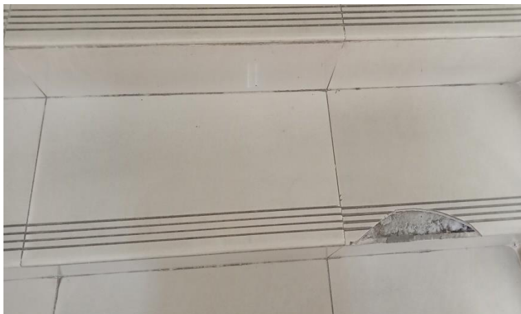
Gambar 4. 26 Keretakan pada lantai keramik Gedung Kantor Bidang Ekonomi, Pembangunan dan Kesra Kampar
