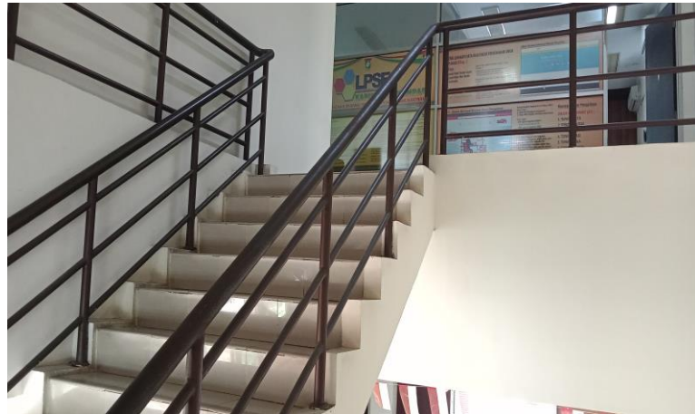
Gambar 5. 22 Parapets pada tangga Gedung Kantor Bidang Ekonomi, Pembangunan dan Kesra Kampar
