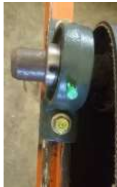
Gambar 4 Rangka dudukan bearing dan setelan roller
