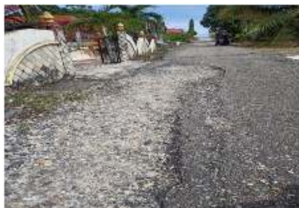
Gambar 4. 2 Kerusakan Gang reformasi 1
