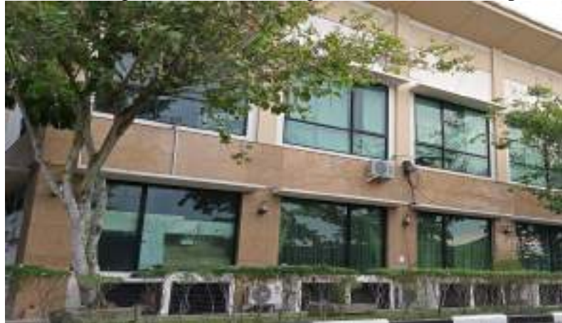
Gambar 5. 70 Beams do not align with coloumns pada Gedung Kantor Bidang Ekonomi, Pembangunan dan Kesra Kampar
