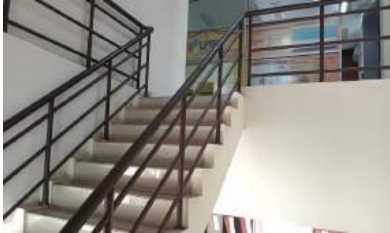
Gambar 5. 9 Parapets pada tangga Gedung Kantor Bidang Ekonomi, Pembangunan dan Kesra Kampar
