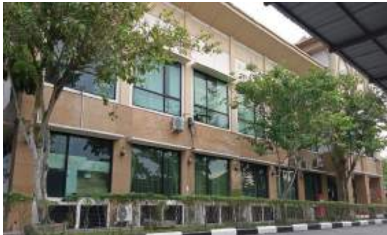
Gambar 5. 10 Heavy Cladding or Heavy Veneer pada Eksterior Gedung Kantor Bidang Ekonomi, Pembangunan dan Kesra Kampar
