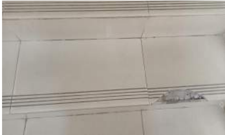
Gambar 5.16 Keretakan pada lantai keramik Gedung Kantor Bidang Ekonomi, Pembangunan dan Kesra Kampar
