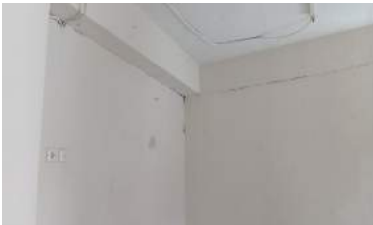
Gambar 5.15 Keretakan pada dinding Gedung Kantor Bidang Ekonomi, Pembangunan dan Kesra Kampar
