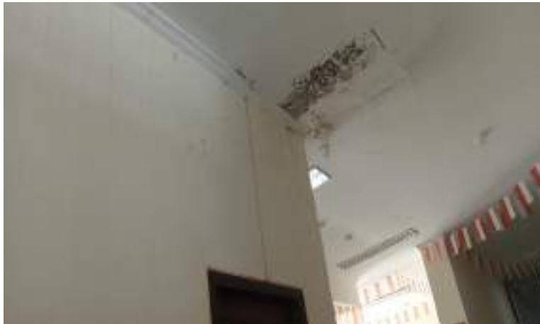
Gambar 5.17 Kerusakan pada plafond Gedung Kantor Bidang Ekonomi, Pembangunan dan Kesra Kampar
